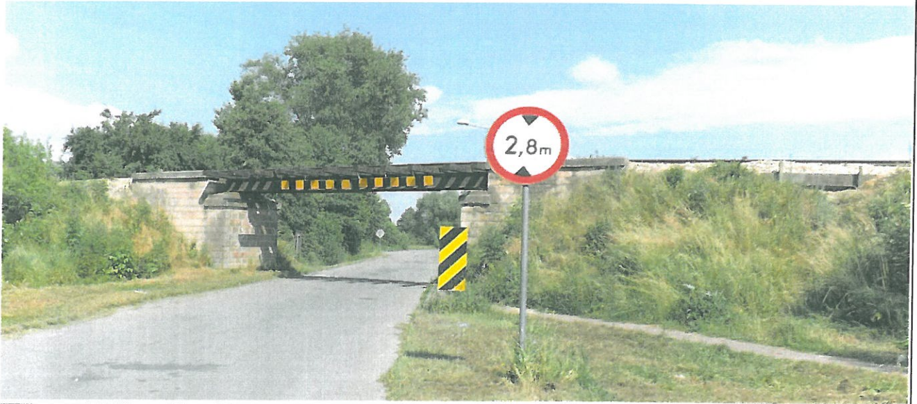
FOT 5 Widok z boku - strona lewa - wegetacja roślinności wzdłuż nawierzchni jezdni/krawężnika - nienormatywny chodnik dla pieszych - skarpy niewyprofilowane, ubytki nasypu
