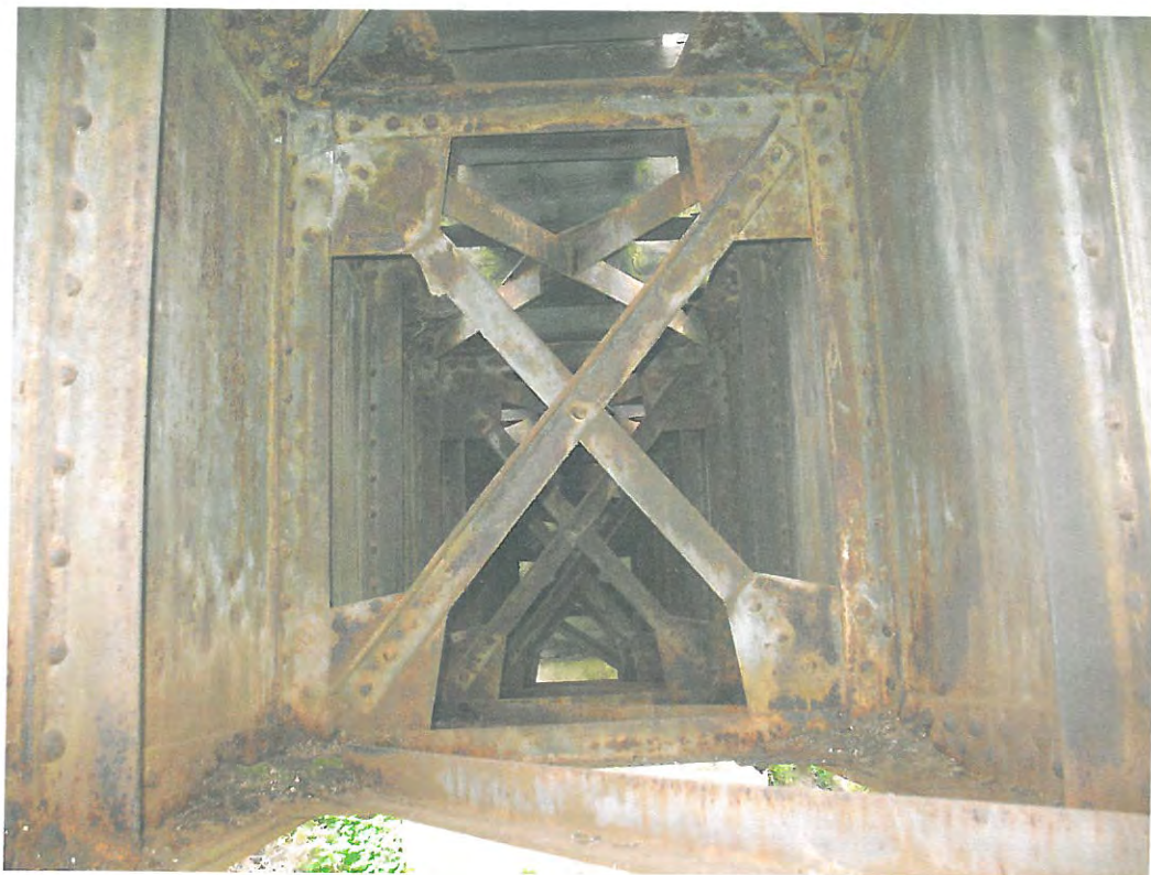
Fot. 6. Widok stężeń poprzecznych i poziomych podłużnych mostu (ślady korozji wgłębnej w węzłach mocowania stężeń)
