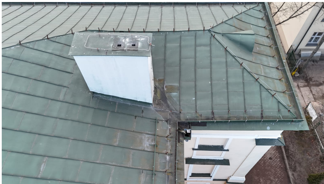
Fot. 1 Widok na stan pokrycia dachowego i obróbkę na dachu, źródło: fotografie własne
