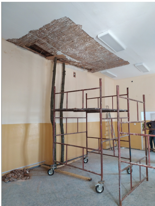
Fot. 3 Widok na uszkodzony fragment stropu nad II pięciem. Uszkodzenia spowodowane przez nieszczelne obróbki blacharskie przy kominie, źródło: fotografie własne
