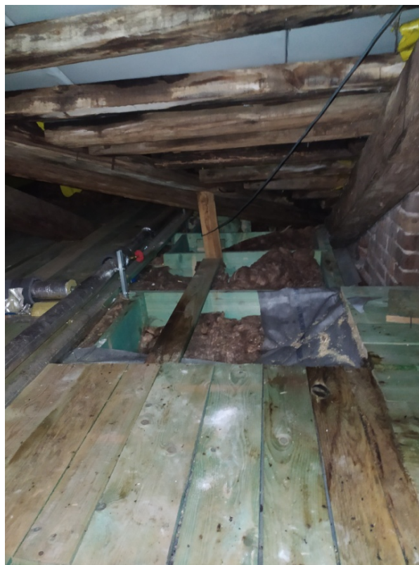
Fot. 4 Widok na uszkodzony fragment stropu od strony poddasza. Widoczne zawilgocenia elementów więźby dachowej, źródło: fotografie własne
