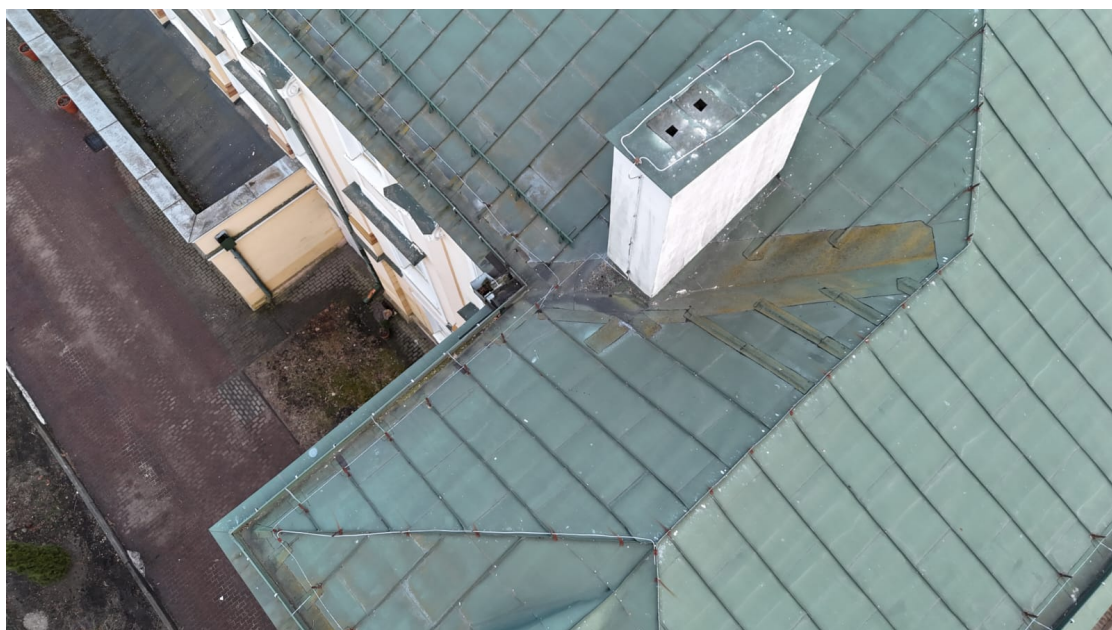
Fot. 2 Widok na stan pokrycia dachowego i obróbkę na dachu, źródło: fotografie własne
