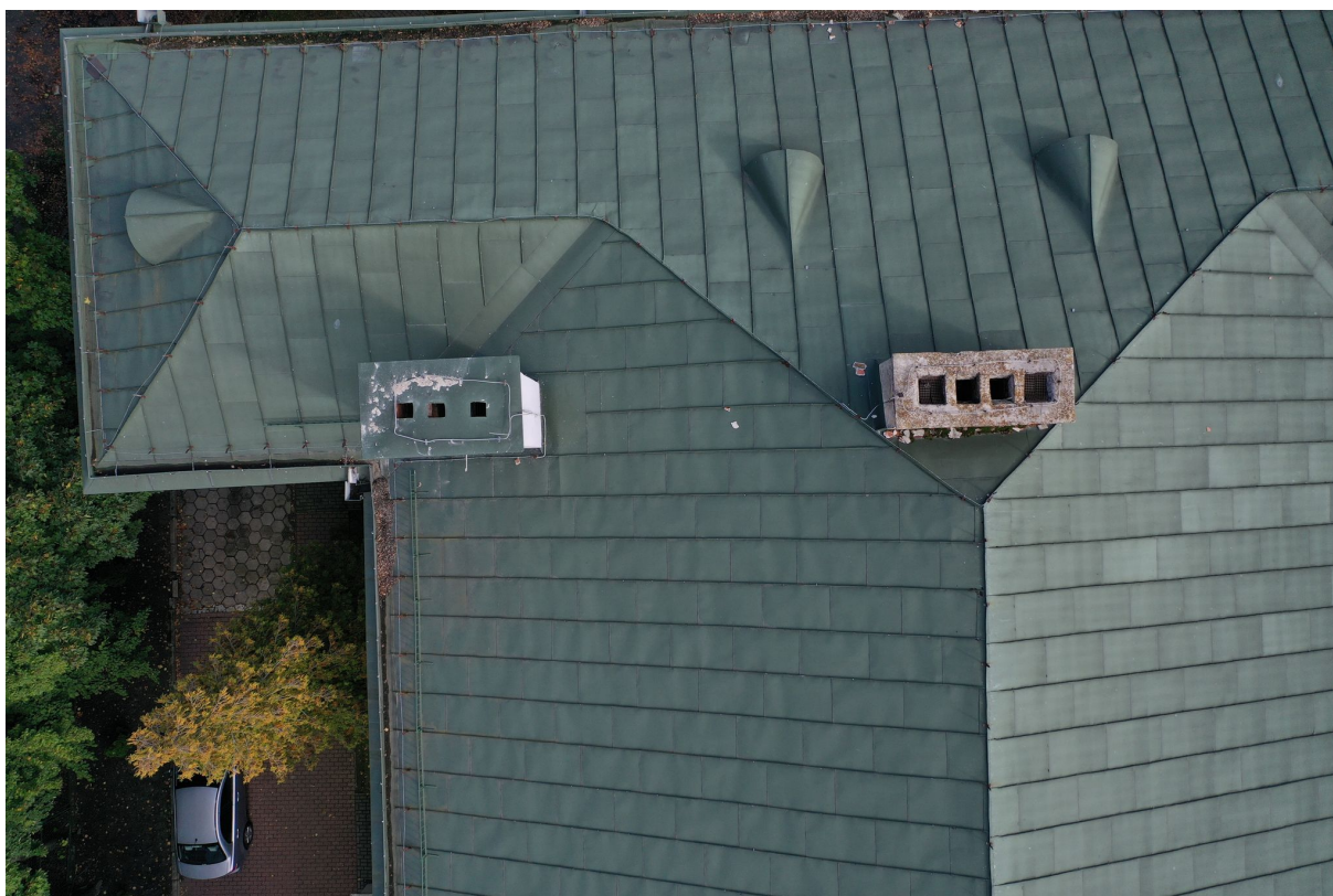
Fot. 6 Widok na dach budynku, zły stan techniczny istniejących kominów, większość kominów wyprowadzona pod połacie dachu, źródło: fotografie własne
