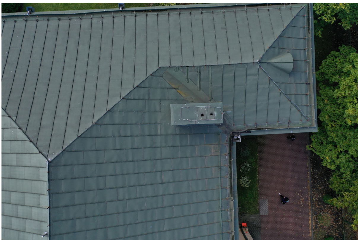
Fot. 8 Widok na dach budynku, zły stan techniczny istniejących kominów, większość kominów wyprowadzona pod połacie dachu, źródło: fotografie własne
