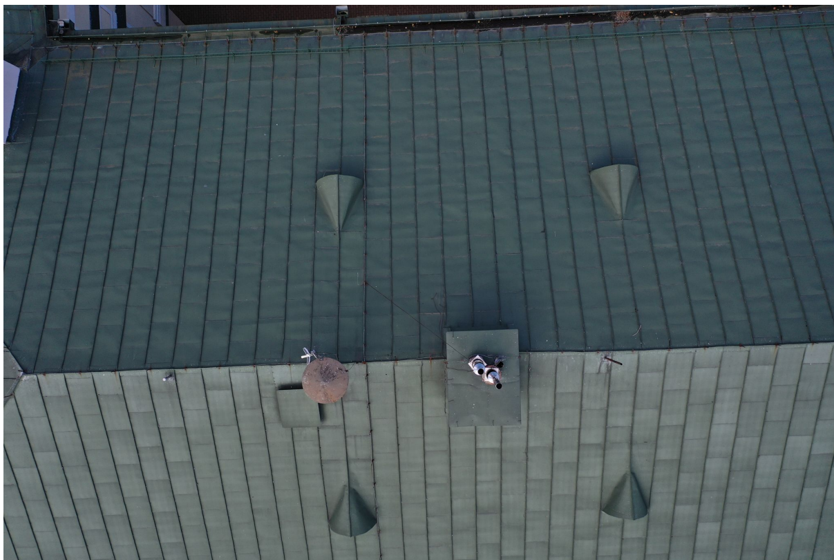
Fot. 7 Widok na dach budynku, zły stan techniczny istniejących kominów, większość kominów wyprowadzona pod połacie dachu, źródło: fotografie własne
