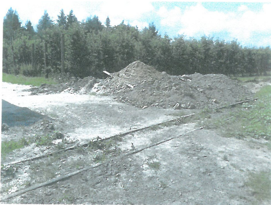
Rys. Nieewidencjonowany przejazd w km 18.150
