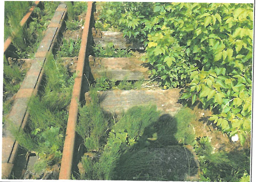
FOT 2 Nawierzchnia - odsłonięte podkłady w obrębie konstrukcji odciążającej
