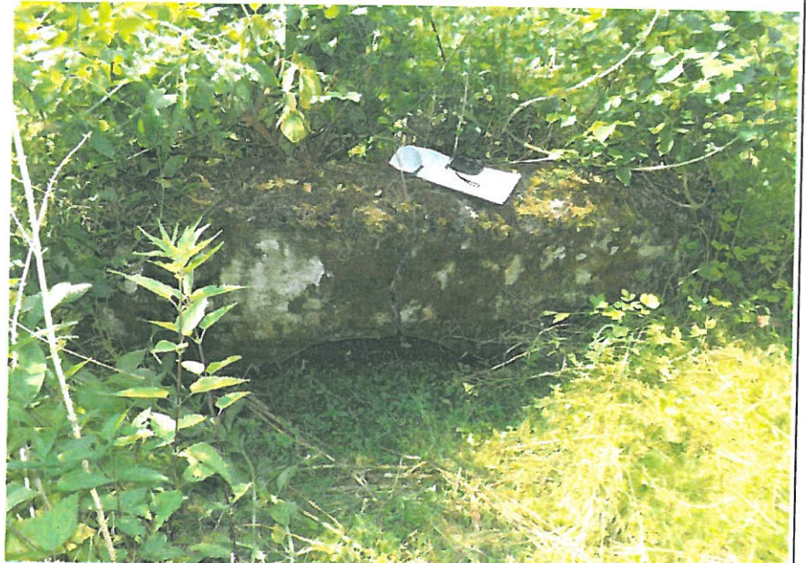
FOT 3 Ścianka czołowa - głowica wlotu (strona lewa) - zanieczyszczenie ściany czołowej wegetującą roślinnością (mchami), osady - spękania i przemieszczenia betonu, ubytki - zanieczyszczenie gzymsu ziemią, roślinnością
