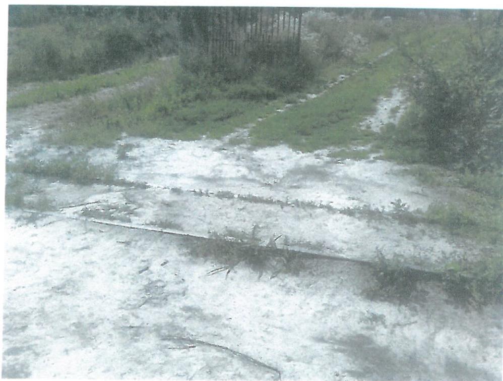
Rys. Nieewidencjonowany zamulony przejazd w km 16.770
