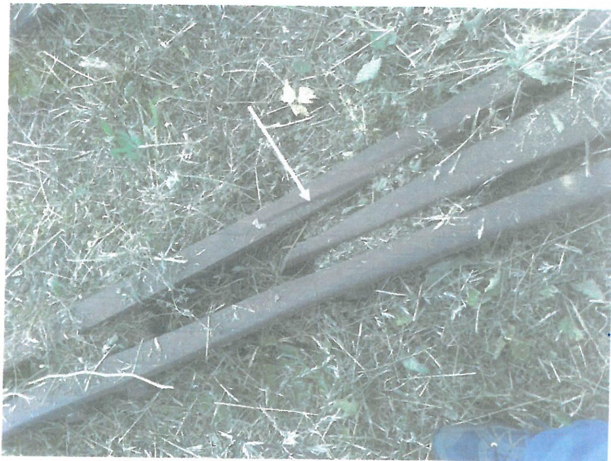
Rys. Zużycie pionowe szyny skrzydłowej krzyżownicy w rozjeździe 31
