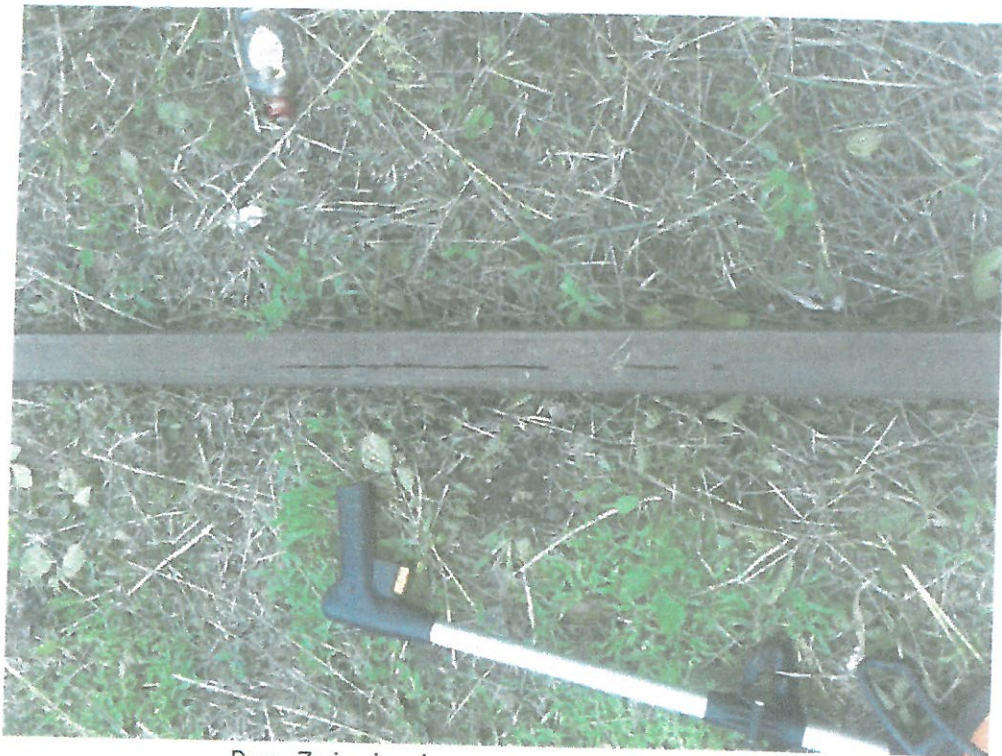
Rys. Zużycie pionowe szyny w km 0.679 typu 38ab
