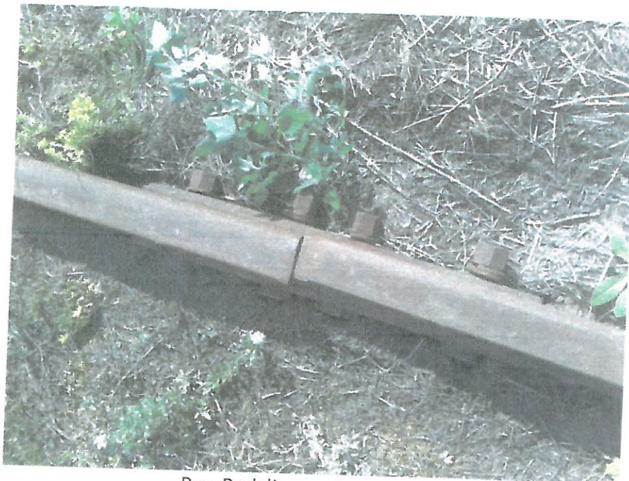
Rys. Brak licowania w poziomie szyn
