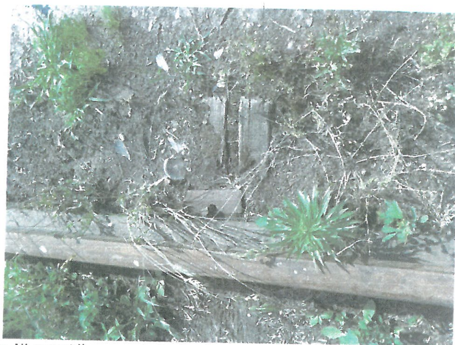
Rys. Nieprawidłowe przytwierdzenie szyny do podkładu, zły stan podkładów
