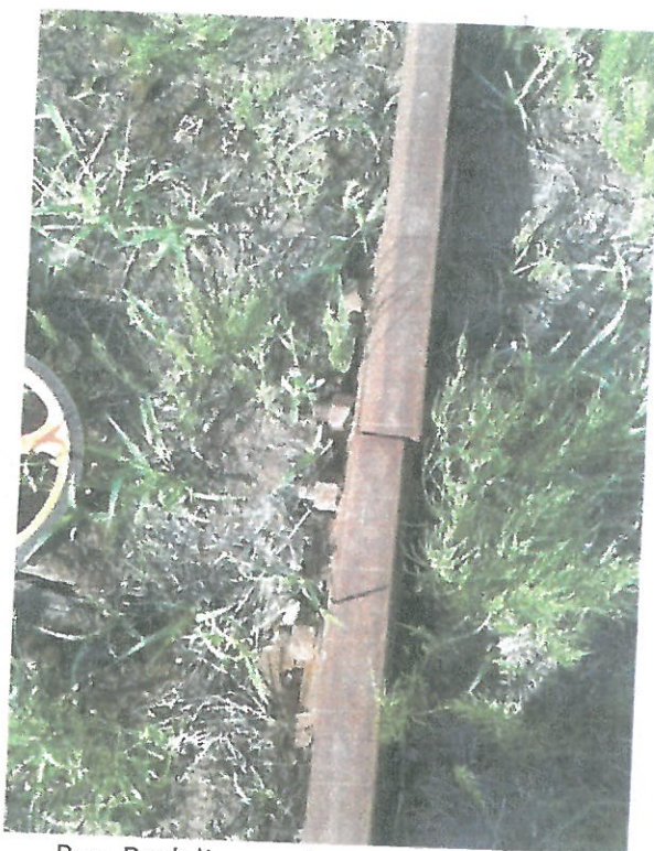
Rys. Brak licowania w poziomie szyn
