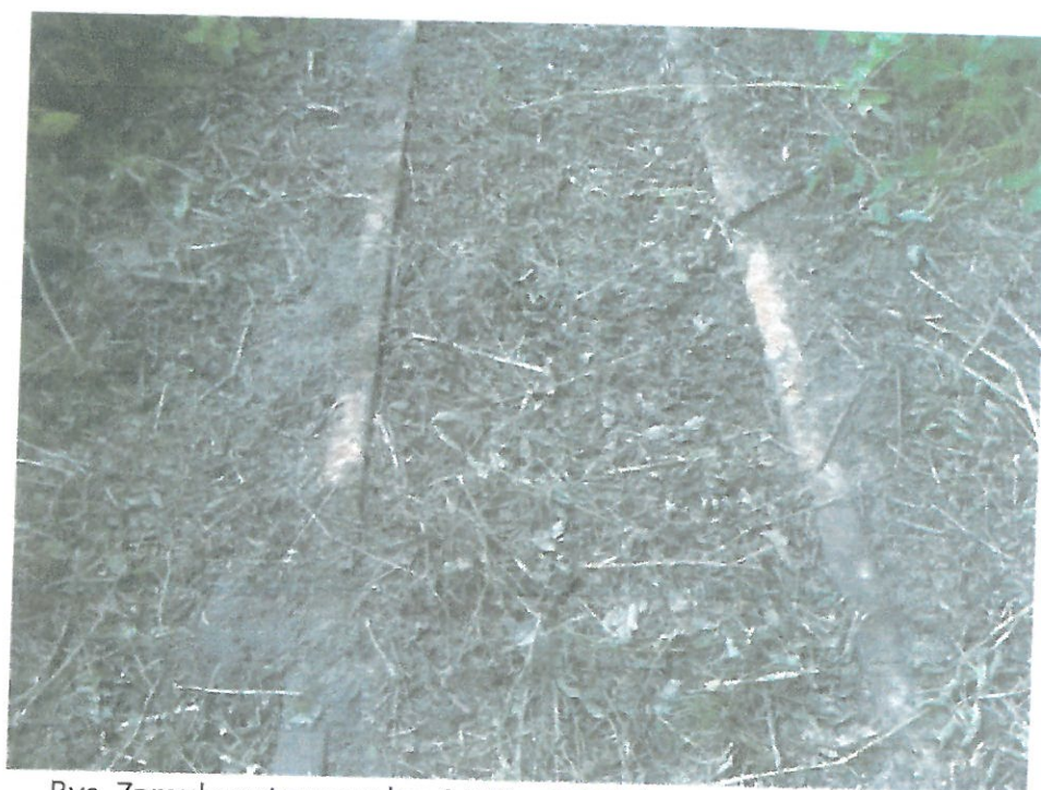
Rys. Zamulony teren w km 6.800 – 6.925 (niewidoczne podkłady)
