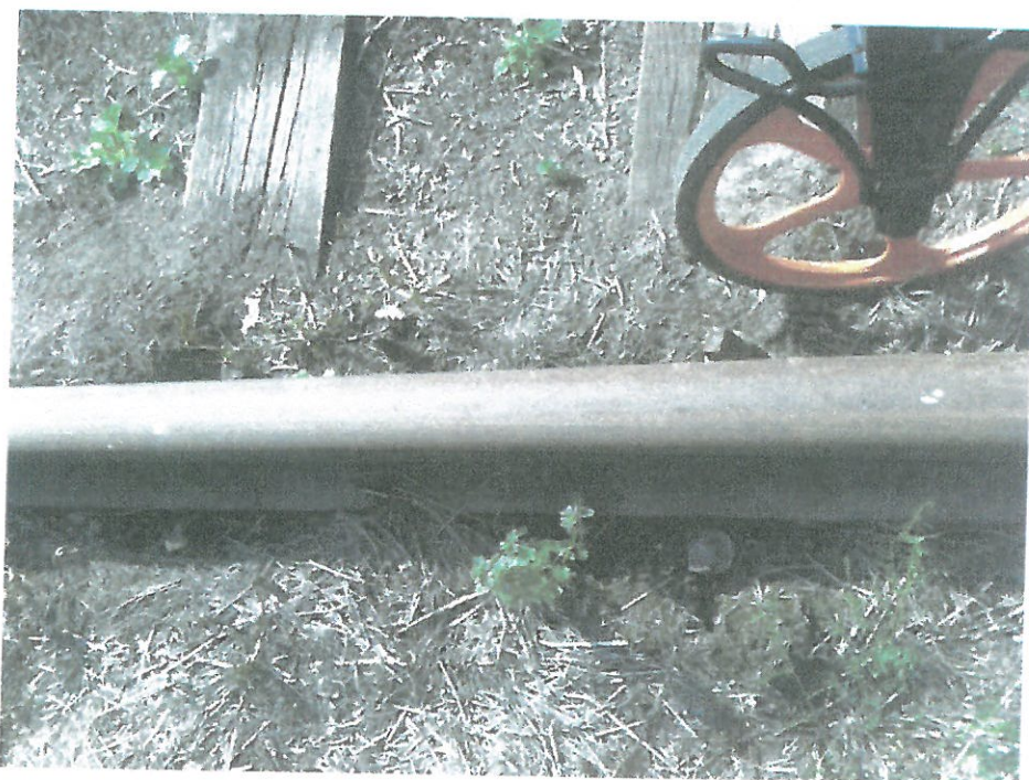
Rys. Szyna nieprzytwierdzona do podkładu w km 17.445
