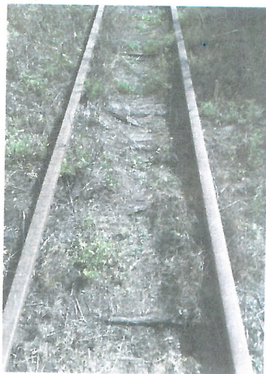
Rys. Uszkodzone podkłady
