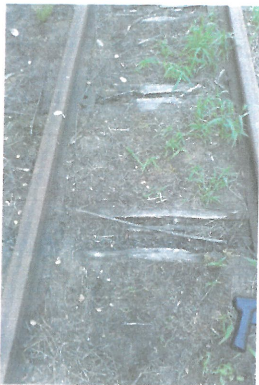
Rys. Uszkodzone podkłady
