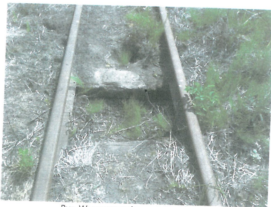
Rys. Wyrwa w podtorzu w km 16.295
