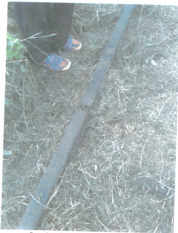
Rys. Przekroczony luz w km 3.740
