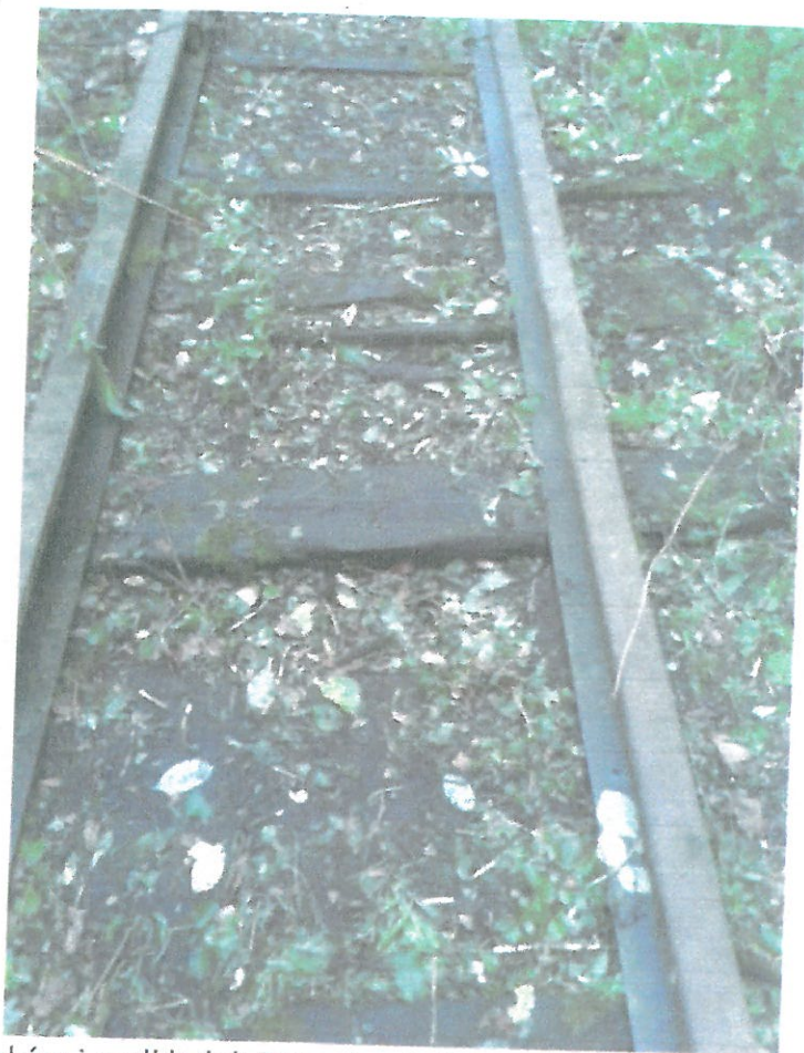
Rys. Brak haków i podkładek P15 w km 3.300 – 3.315 (nieprzytwierdzony tor)
