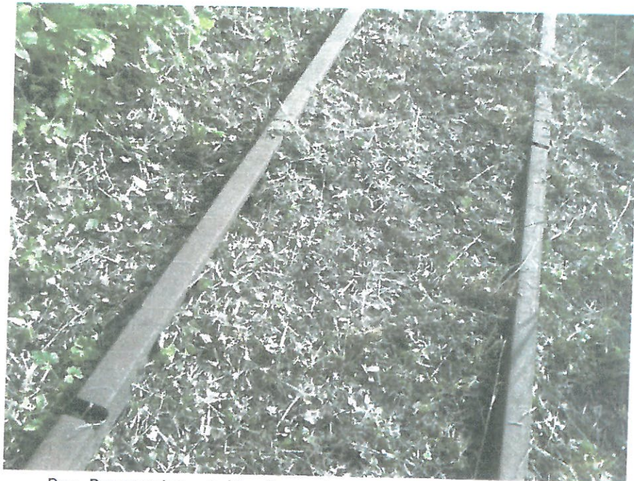
Rys. Przesunięte styki o 2 m w km 5.640, przekroczone luzy
