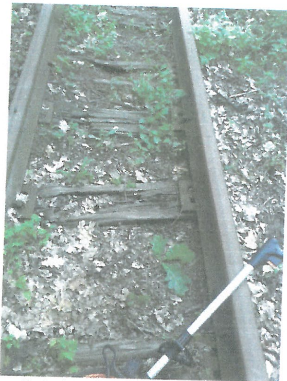
Rys. Uszkodzone podkłady na tuku w km 9.750
