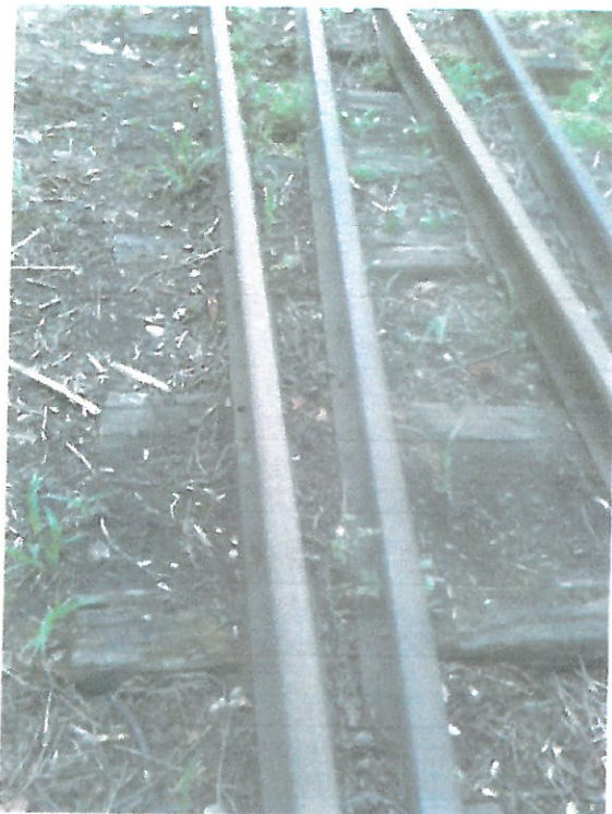
Rys. Nieprzytwierdzona szyna łącząca (brak podkładek i haków)
