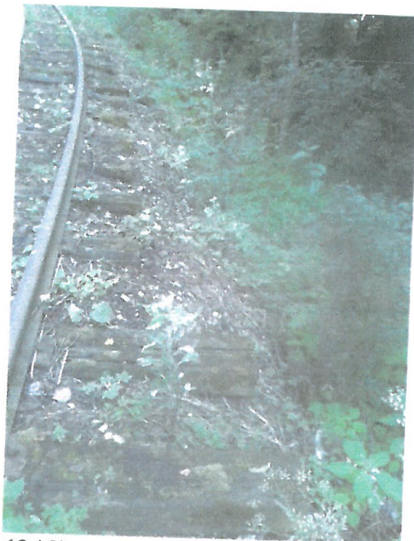
Rys. W km 12.160 na nasypie w łuku nieobsypany tok zewnętrzny
