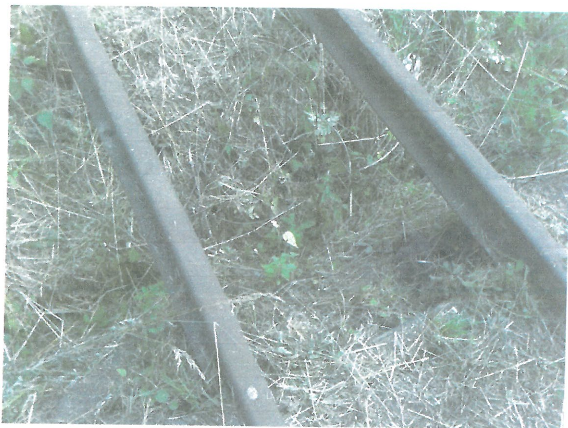
Rys. Wyrwa w podtorzu, nieprzytwierdzony tor w km 7.050
