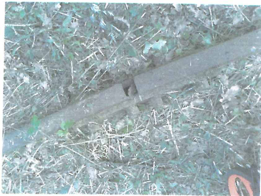
Rys. Przekroczony luz w km 5.730
