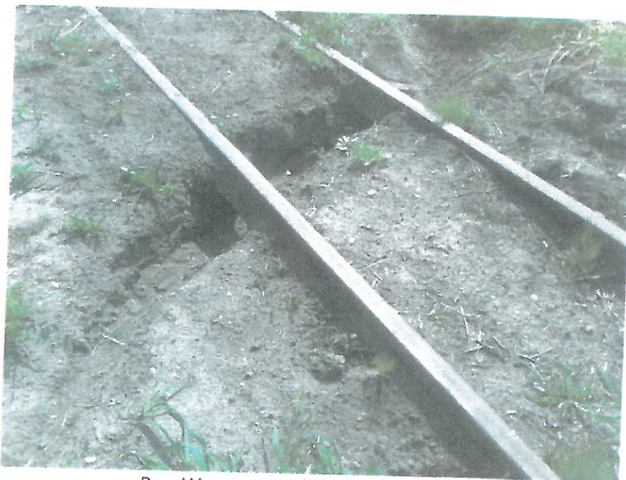
Rys. Wyrwa w podtorzu w km 16.855
