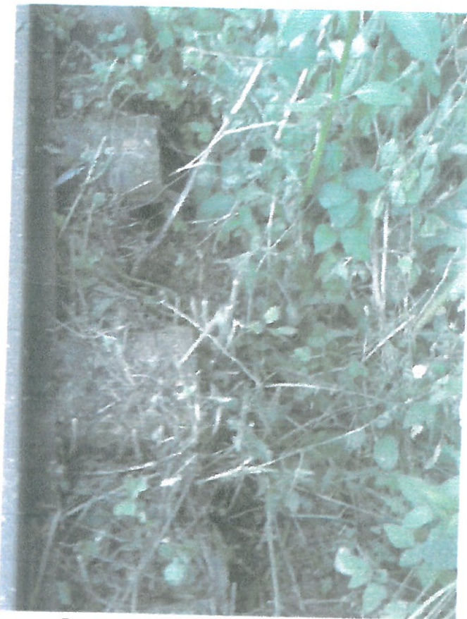
Rys. Wyrwa w podtorzu w km 6.815
